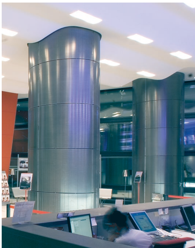
Colonnes de ventilation
