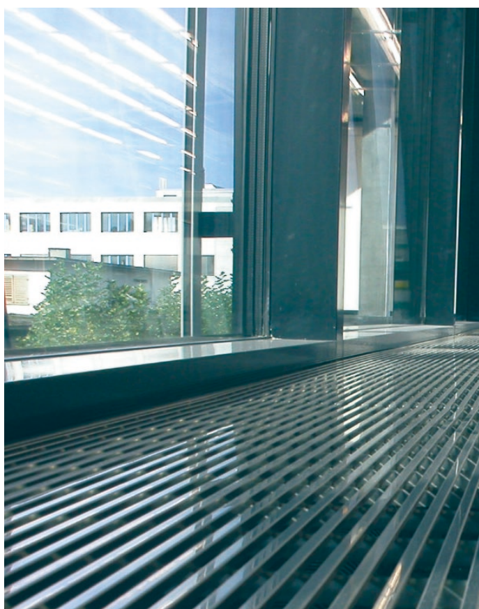
Grille de ventilation de sol
