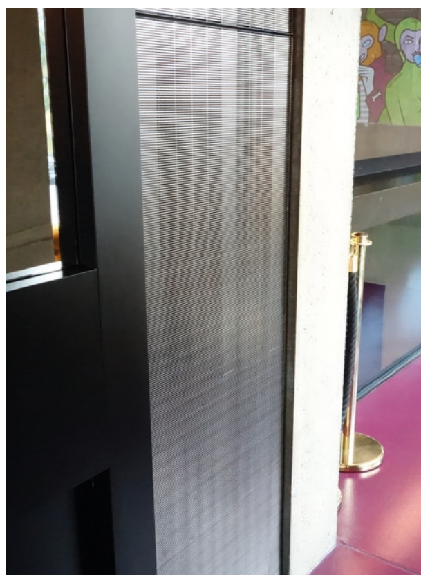
Grille de ventilation
